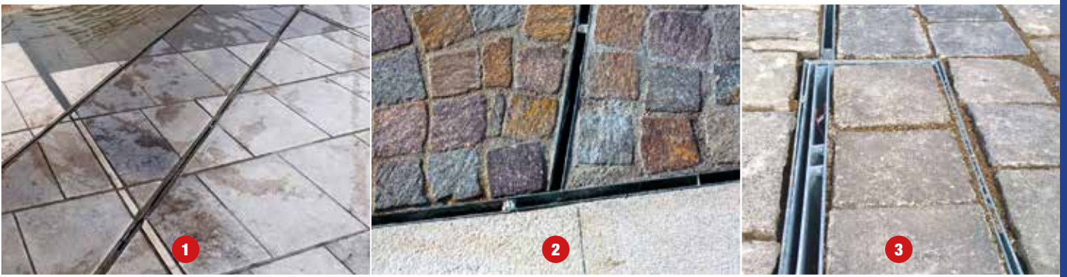
1 2 FOTO DELLA GRIGLIA A FESSURA
